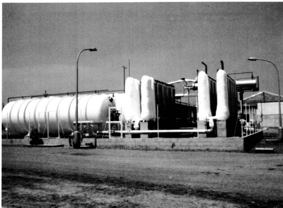
Instal·lacions de la nova fàbrica de gas.
