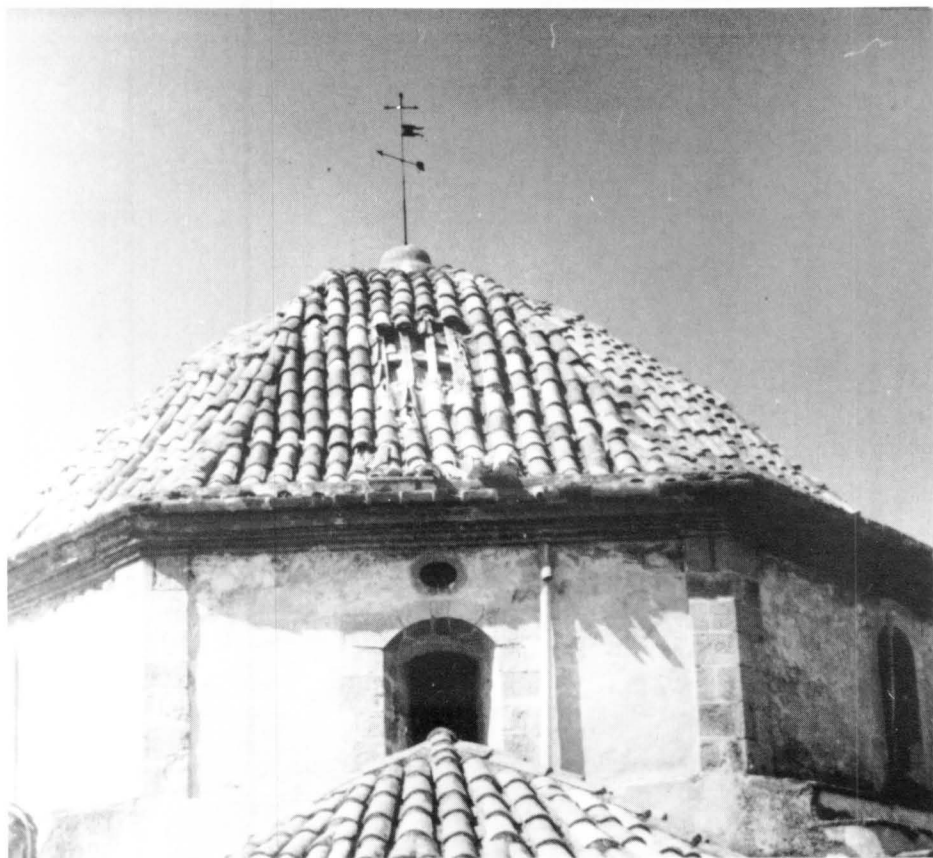
Esvoranc produït per una tempestat a la cúpula, en la Setmana Santa de l'any 1974.
