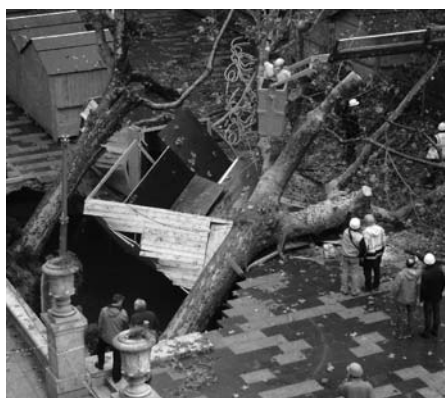
Tècnics i operaris al lloc de l'esvoranc a la Rambla de Figueres. Autor: Josep Maria Dacosta.
