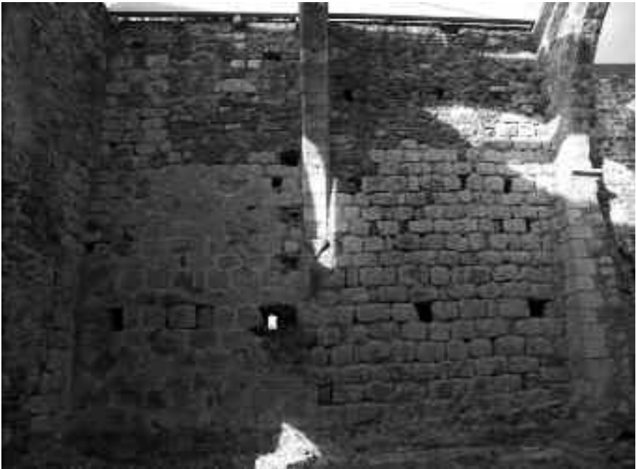
Figura 3. Interior de la paret nord, on podem veure com hi ha una refacció de la paret en el punt de contacte amb el nervi de la volta.
