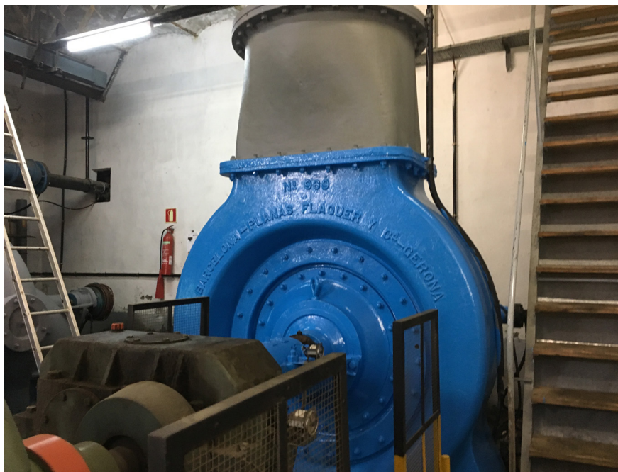
La turbina del pont de la Cabreta és la més antiga de la comarca.
