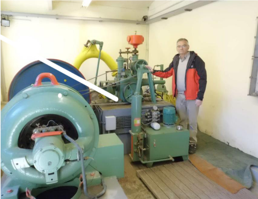
Joan Díaz davant el regulador (2016) de la central hidroelèctrica de Núria. (2016)
