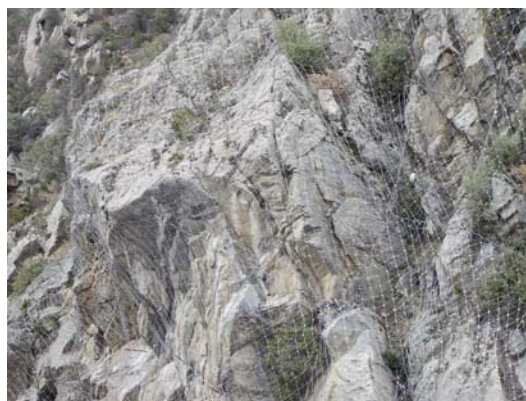
Fig. 21: Ejemplo de protección activa (malla pentifix) en Andorra la Vella en el año 2004. (Foto efectuada por R. Copons para Euroconsult S.A. en Andorra).
