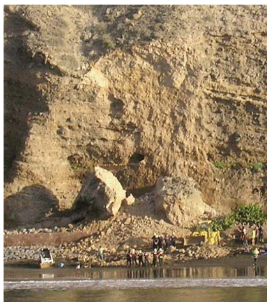
Fig. 18: Bloques desprendidos en la playa de Los Gigantes (Tenerife). (Por cortesía de Lola Marro, http://loquepasaentenerife.com ).
