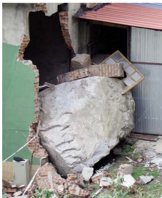
Fig. 2: Impacto de un desprendimiento en un edificio en Santa Coloma (Andorra) en abril del 2008. (Foto: Ramon Copons).
