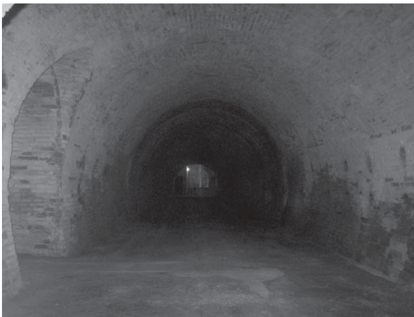
Aspecte de les galeries de les mines interconnectades de la cava a 10 metres de profunditat.
