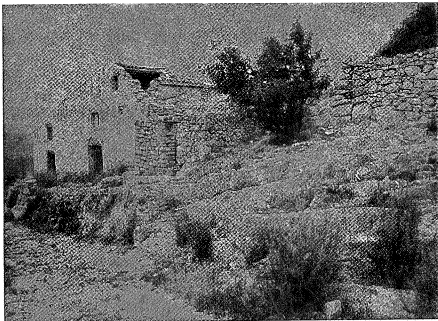
Esta estampa de abandono es habitual en esta zona. De todas formas, el techo de esta edificación ha sido afectado por un rayo que lo destruyó en parte. Las tormentas son frecuentes y de caracteres monumentales, llevándose las escorrentias producidas la tierra del camino y aun de las terrazas
