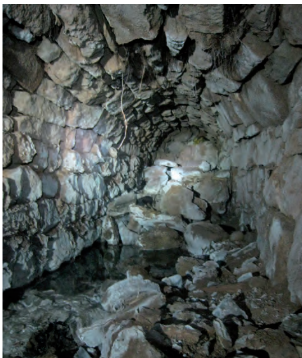
Estat inicial del principal esfondrament interior de la galeria de la mina l'any 2009 (J. Morros)
