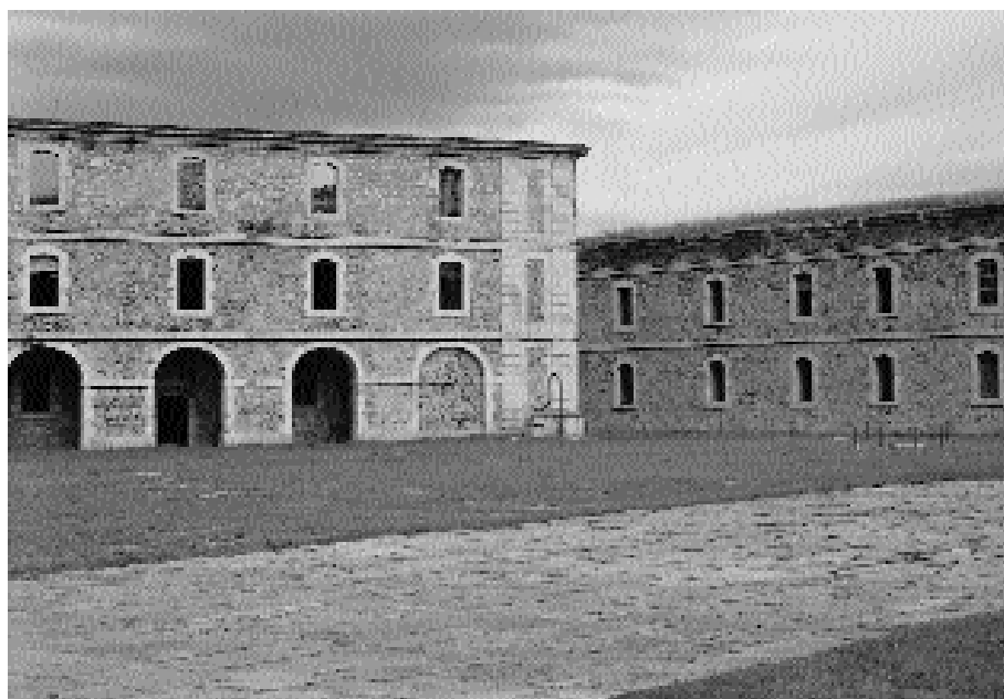
Figura 8. Imatge on es pot comparar una façana original i la reformada segons el projecte Bonell. (Fotografia de l'any 2000).
