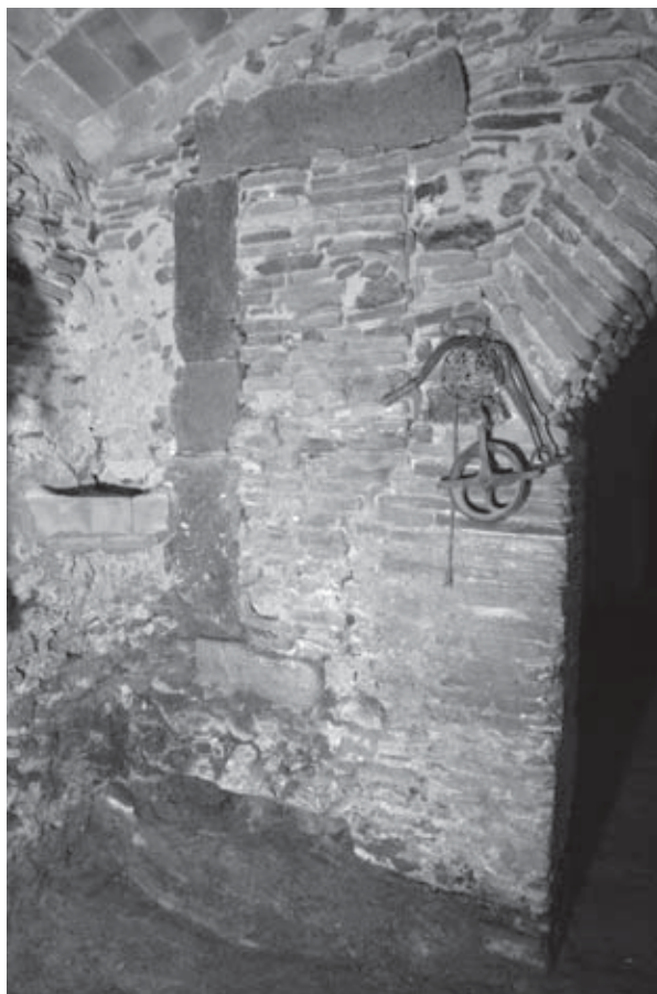
Figura 12. Obertura, avui tapiada i malmesa en el seu brancal oest, que comunicava el dipòsit de la figura 10 amb la part de les cases annexes a l'oest.
